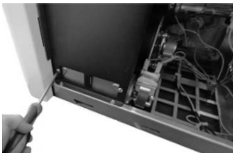
Fig. 96 - Nettoyage de le ventilateur ambiant
