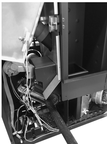
Fig. 78 - Nettoyage de le ventilateur ambiant
